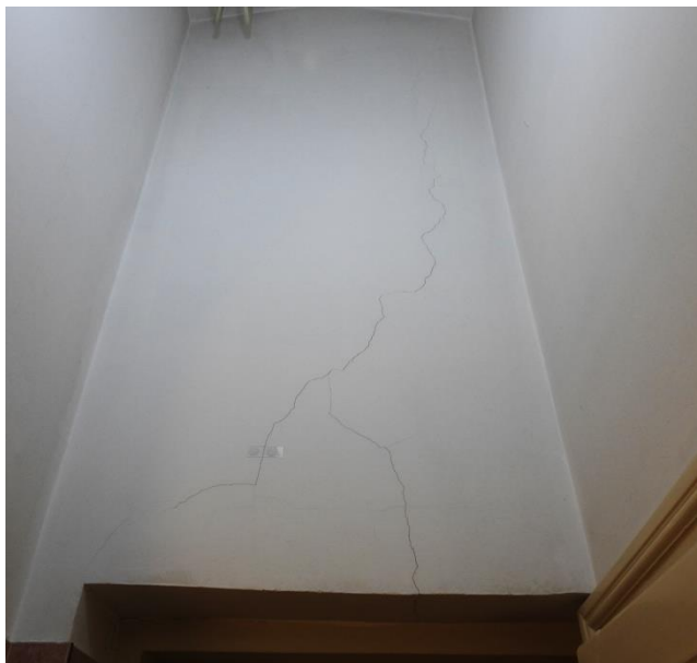
Slika 22: prikaz razpok v J zidu sanitarij pritličja
