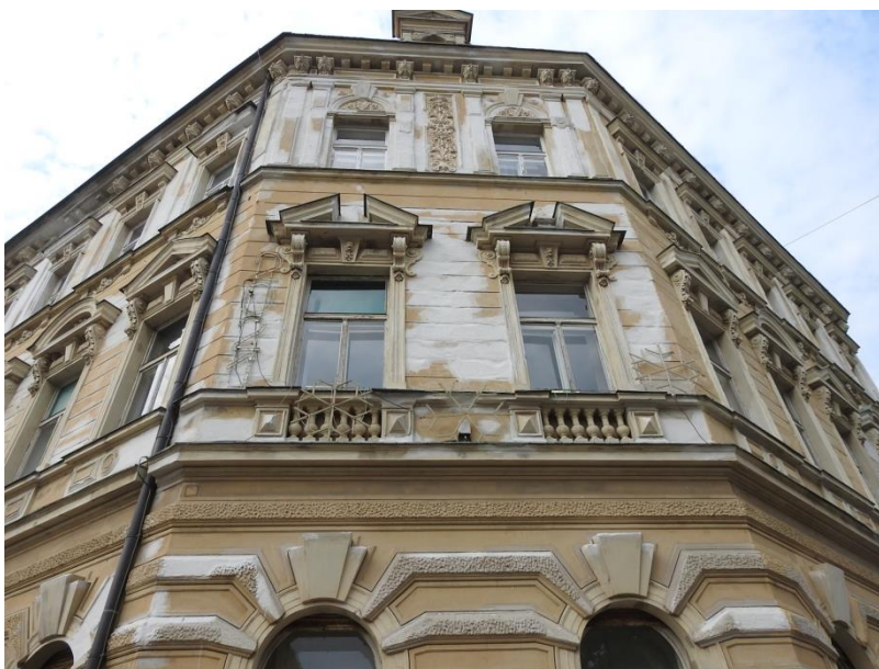
Slika 30: prikaz stanja fasade v predelu loma objekta
