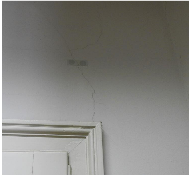
Slika 26: prikaz razpoke iz desnega zgornjega vogala vrat v sanitarije 2. nadstropja
