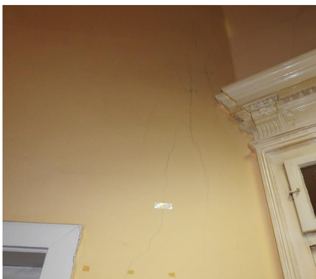
Slika 16: prikaz razpok v S zidu hodnika v predelu loma objekta
