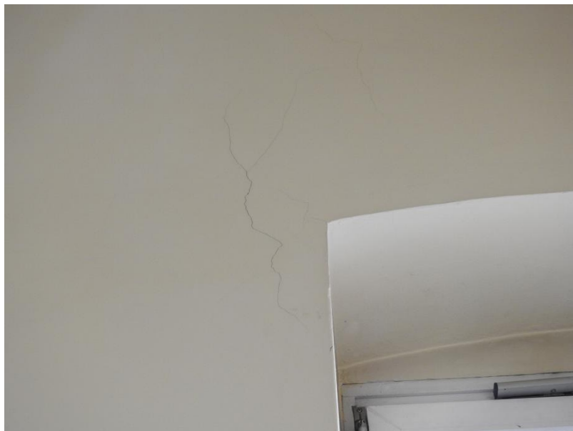
Slika 24: prikaz razpoke v H zidu ob levi špaleti okna hodnika v predelu kraka Raičeva
