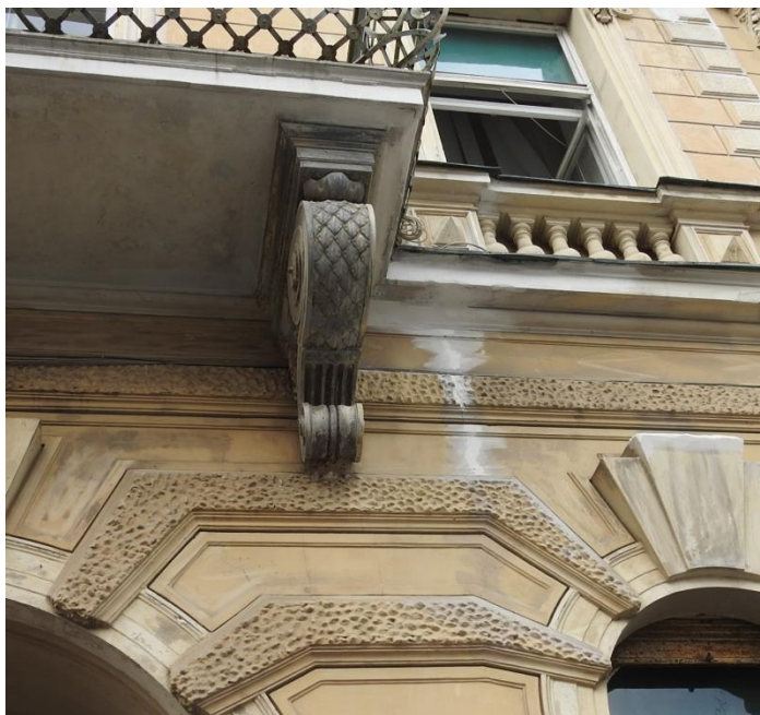
Slika 28: prikaz razpoke desno od balkona v 1. nadstropju
