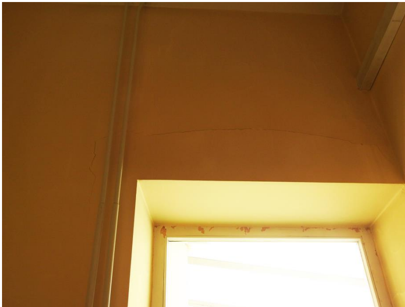
Slika 18: prikaz razpoke v J zidu hodnika v kraku Raičeva
