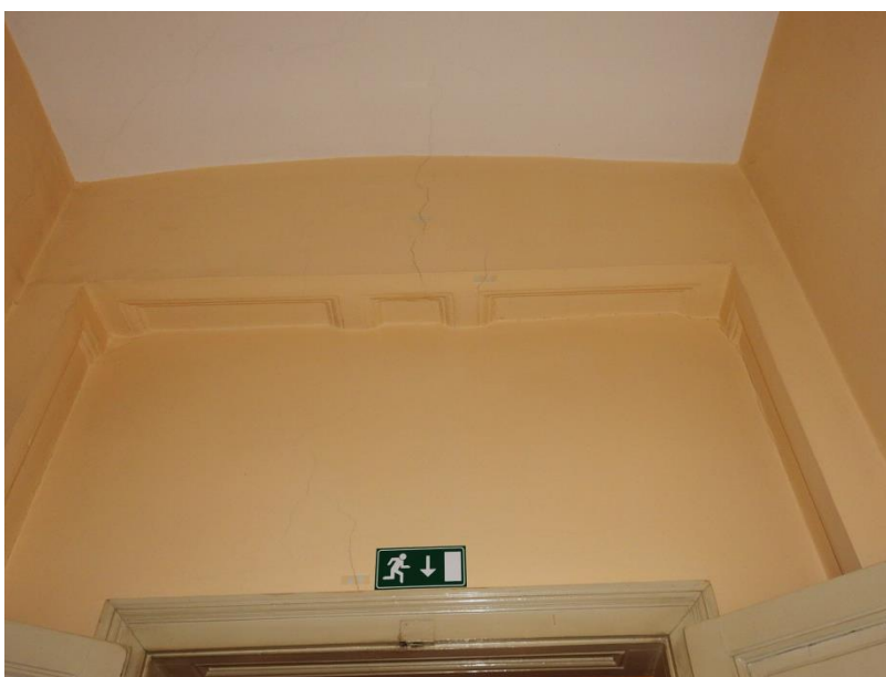
Slika 19: prikaz razpoke prekladi zidu prehoda v hodniku
