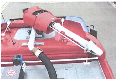
Slika 1: Primer montaže gasilnega topa
