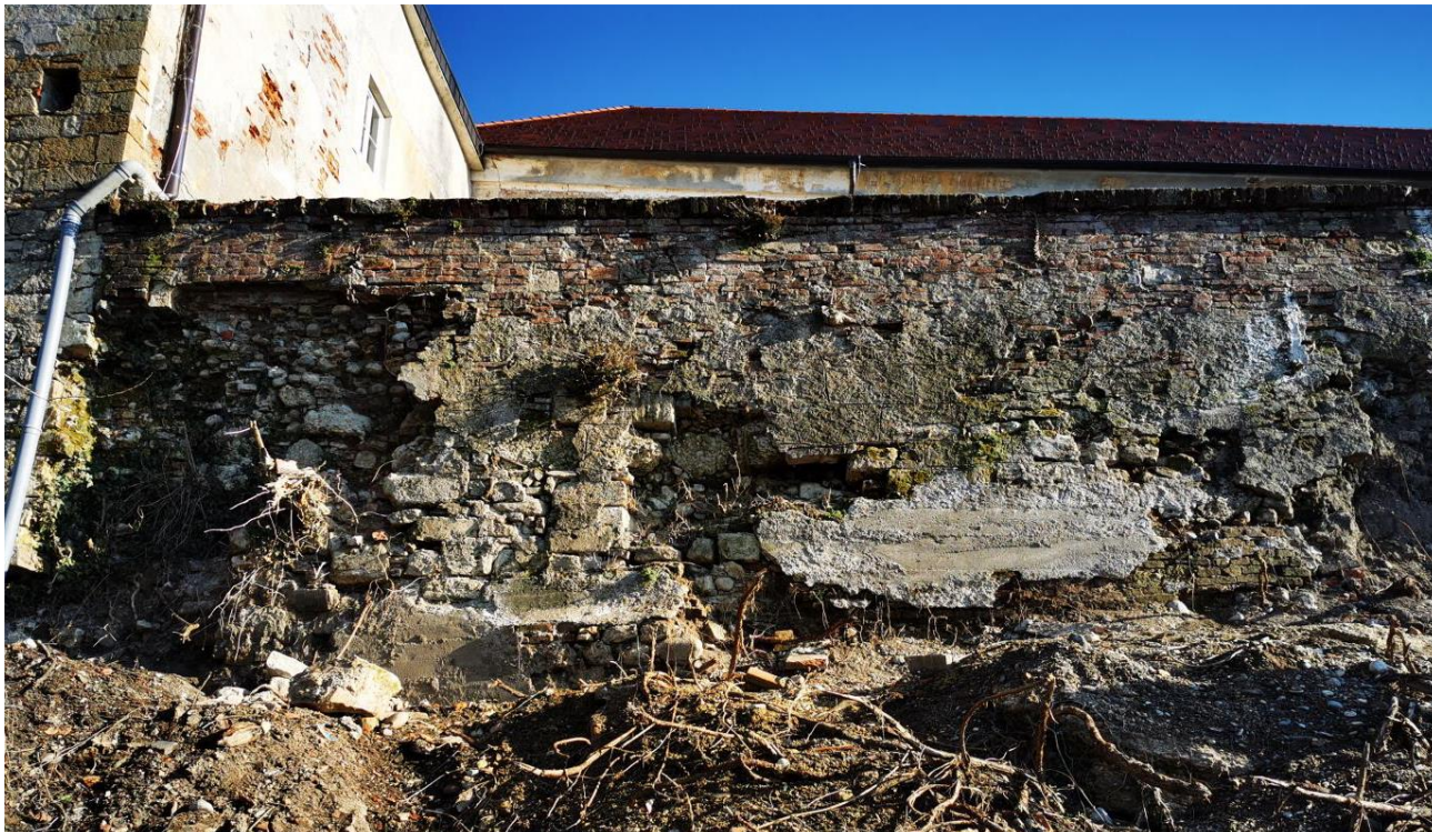
Slika 2: Pogled na levo stran zidu-vidna izrazita poškodovanost, AB plombe...(Vir: PZI dokumentacije, Irgo d.o.o.)
