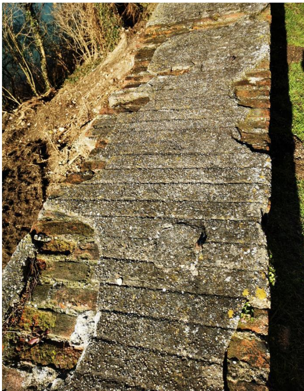
Slika 5: Pogled na krono zidu-vidna izrazita poškodovanost opečnih gradnikov in ometa ...(Vir: PZI dokumentacije, Irgo d.o.o.)
