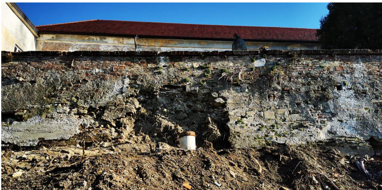
Slika 3: Pogled na osrednji del zidu-vidna izrazita poškodovanost, AB plombe...(Vir: PZI dokumentacije, Irgo d.o.o.)
