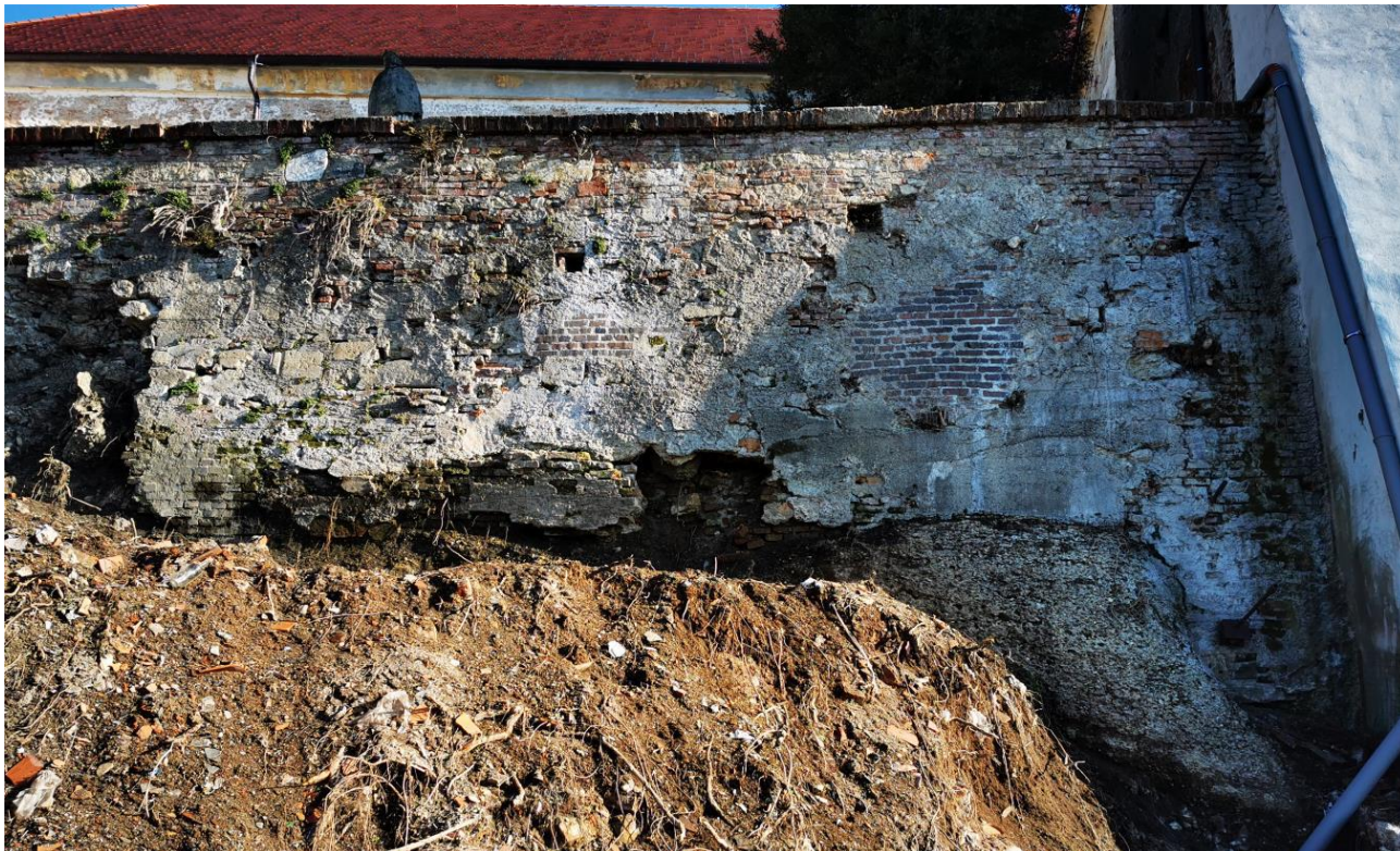
Slika 4: Pogled na desni del zidu-vidna izrazita poškodovanost, AB plombe, plombe iz klinker opeke...(Vir: PZI dokumentacije, Irgod.o.o.)
