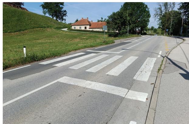
Slika 23: Eden od pomanjkljivo urejenih prehodov za pešce, ki je potreben nadgradnje (na sliki prehod za pešce na Raičevi ulici pri avtobusnem postajališču).
